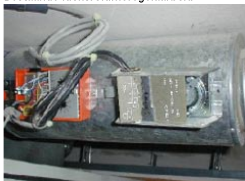
Bestaande lucht volumeregelaarbox:
